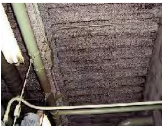
石綿含有吹付けロックウール
